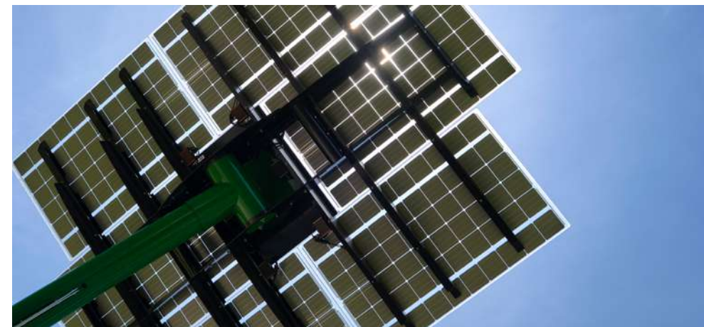
Panamá Solar Panels
